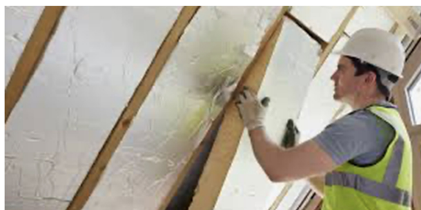
isolatie onder een schuine kap
